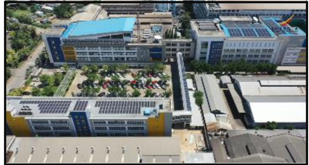
Solar PV yang telah dipasang pada Gedung Pamapersada Nusantara Head Office
