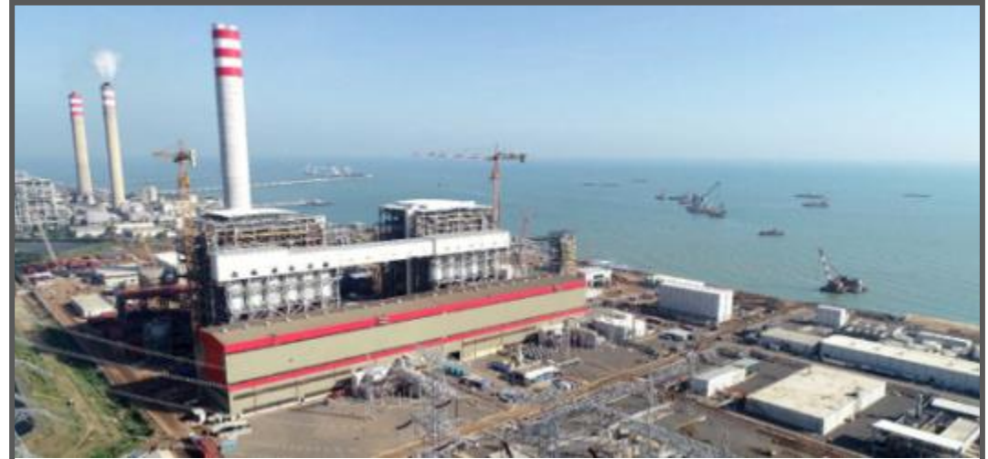
PLTU Jawa-4 (Tanjung Jati 5 & 6) 2x1.000 MW Lokasi : Jebara, Jawa Tengah Sampai bulan Juli 2021, progress pembangunan telah mencapai 99% dan dijadwalkan akan mulai beroperasi secara komersial pada tahun 2022.
