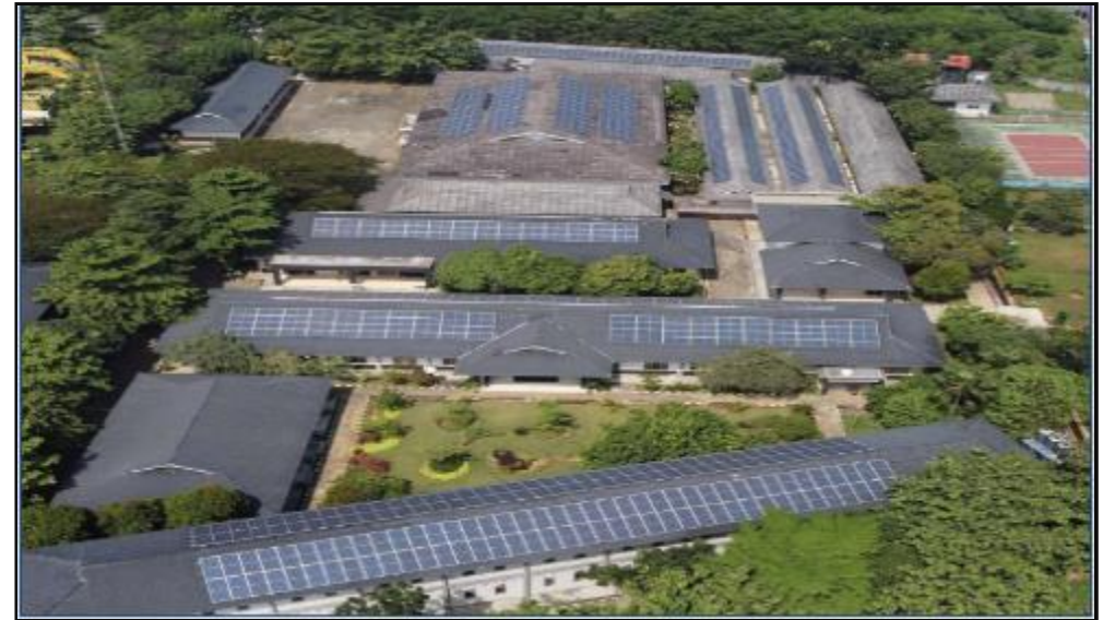
Solar PV yang telah dipasang pada Site Pamapersada Nusantara
