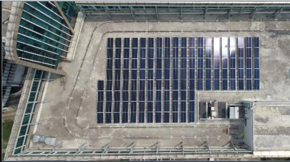
Solar PV yang telah dipasang pada Gedung United Tractors Head Office
